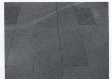
写真 5.1 リフトアップ現象による段差とズレ
